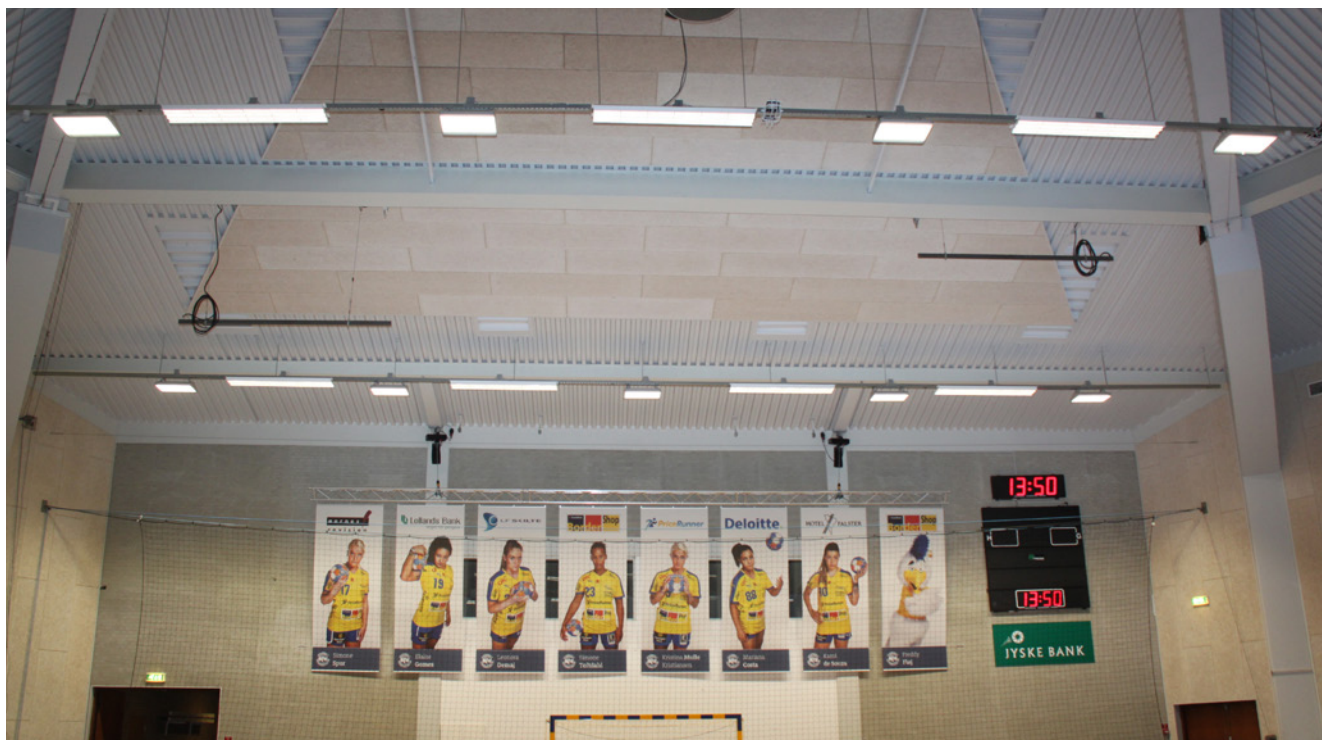
Højager Belysning har leveret LED-lys til Nykøbing Falster Hallen. På grund af hallens konstruktion er armaturerne nødt til at sidde på bestemte kabelskinner i loftet. Og for at dække hele gulvet ensartet var man nødt til at kombinere to forskellige slags armaturer fra Philips.
